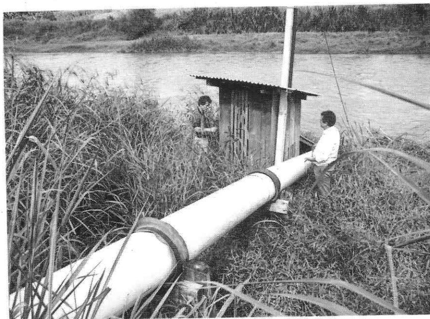
Captação de água para uso coletivo em irrigação
